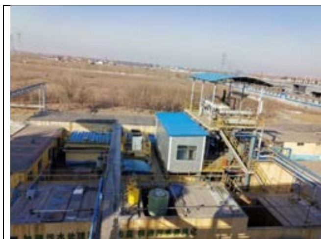
污水生化处理装置
