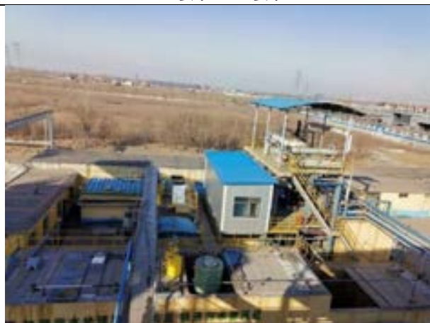
污水生化处理装置
